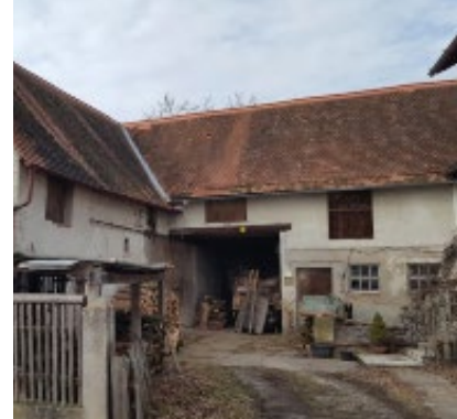
Abb.21: Schlechter Gebäude- und Hofzustand
