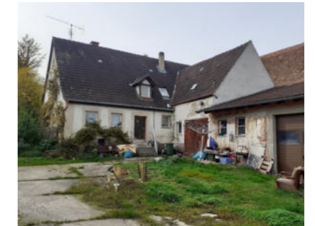
Abb.21: Schlechter Gebäudezustand, Steppach 76
