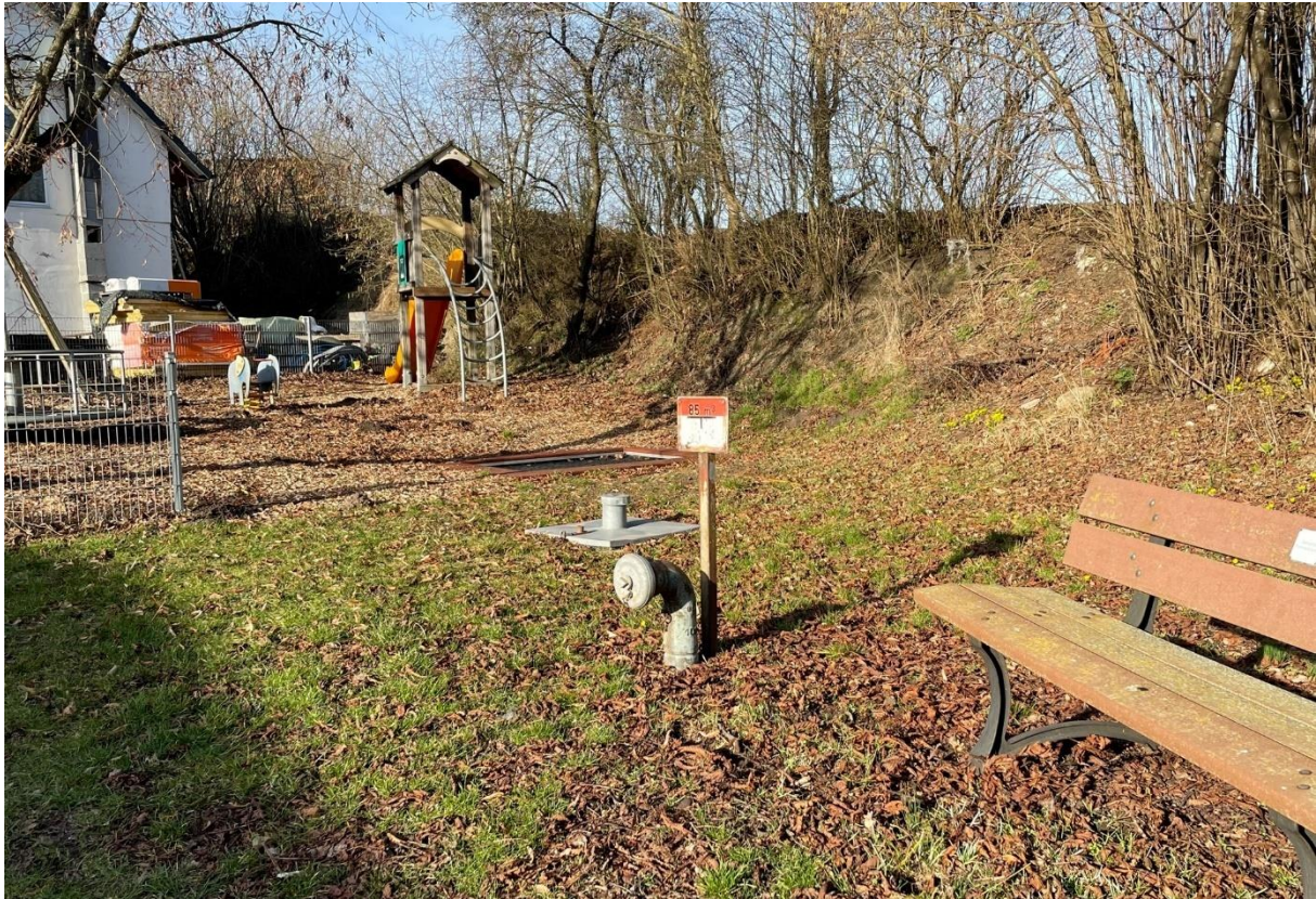
Löschwasserentnahmestelle: Stolzenroth (85 cbm)
